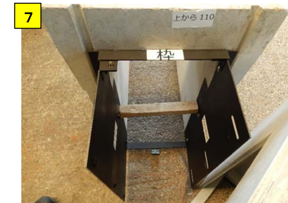
7 枠の位置が決まったらバタ角でしっかり固定しトラスネジとナットを締め込み、側溝と枠・短辺固定・長辺固定を完全に一体化させる
