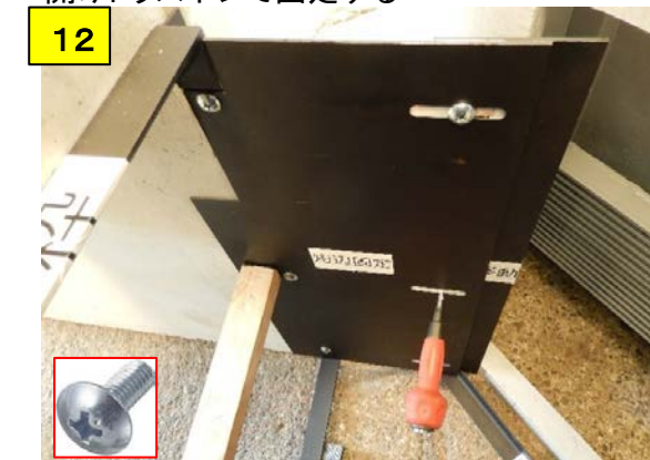
12 短辺移動の位置を調整しながらトラスネジで固定する
