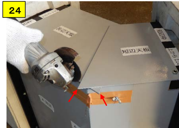
長辺天板と短辺天板の出っ張り部分をグラインダー等で両方とも切断する
